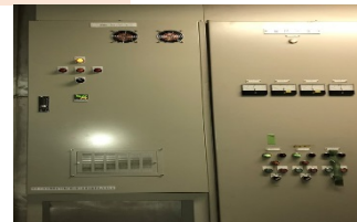
インバータ制御盤
