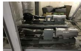
冷温水2次ポンプ
